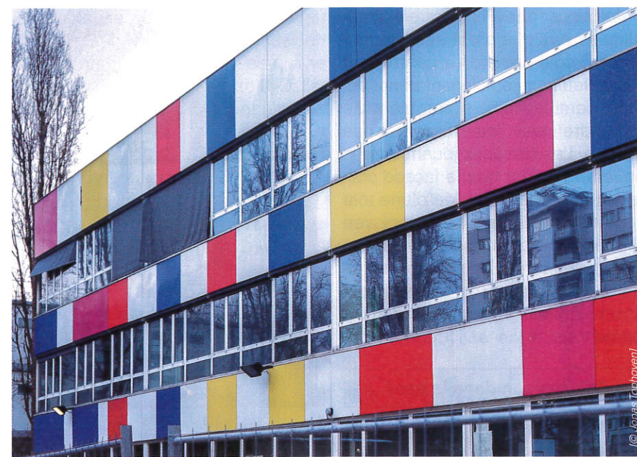
Bâtiment A de l'école élémentaire avant travaux, avec des allèges de couleur côté Est.
